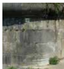
Traces d'usure laissées par les cordes de halage sur la pile du pont du chemin de fer
